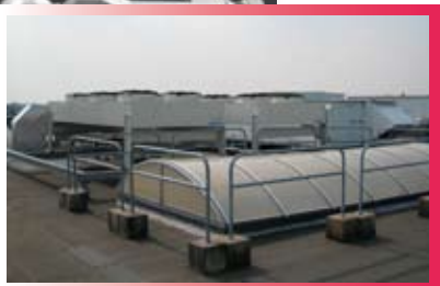
2 droge koelers gekoppeld aan 5 binnen opgestelde CCU's
